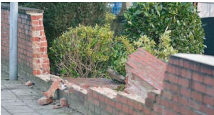
In der Nacht zum 3. Februar wurde die Mauer an der Evangelischen Kirche in Cloppenburg von einem ins Schleudern geratenen Fahrzeug teilweise eingerissen. Der Fahrer meldete sich nach dem Vorfall unaufgefordert bei der Polizei. Die Mauer soll demnächst in Rücksprache mit der Versicherung des Fahrzeughalters wieder errichtet werden. (wk)
